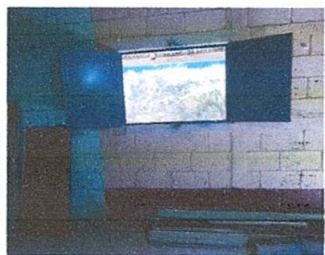
Foto 9: ampliación de dos ventanas de un aula, de 2mX1m ventana y balcón
