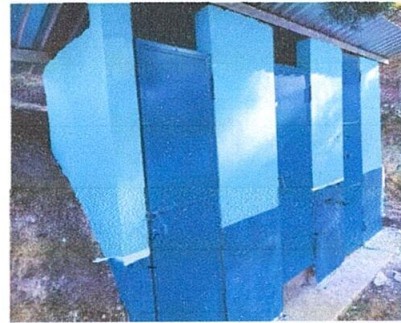
Foto 4: sustitución de puertas, repello y pintura de paredes inrior y exterior, sustitución de tazas de tazas de 2 baños
